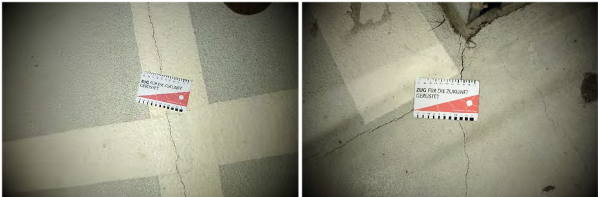
Abbildung 3: Typisches Rissbild über den Auflagerträgern (links) und im Rampenbereich (rechts)
