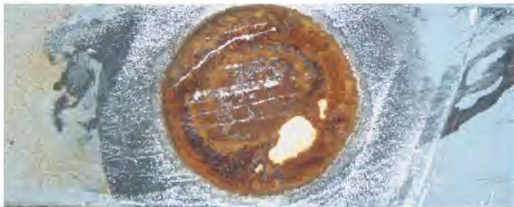
Abbildung 36: PK 6 nach der elektrochemischen Korrosion - Beschichtung hinter Blech sichtbar
