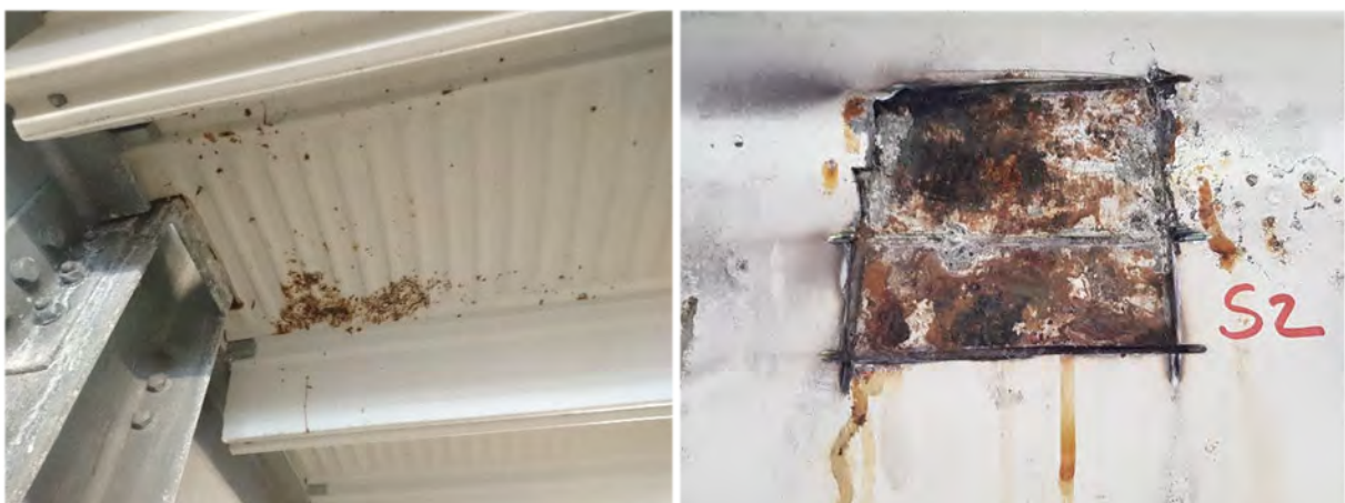
Abbildung 4: Korrosionsspuren an der Deckenunterseite (links) und Öffnungsstelle am Blech (rechts)
