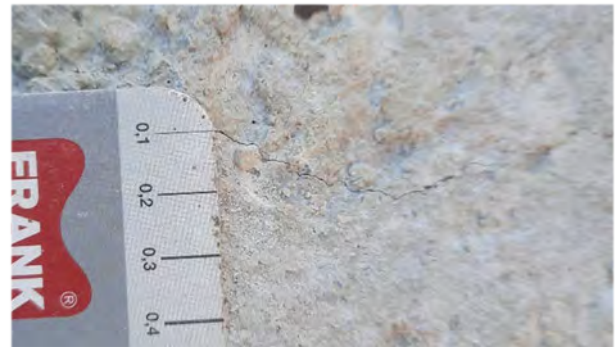
Abbildung 107: Pilotprojekt Kissing - Rissbildung über den Auflagerträgern im Zuge der ersten Probelastung
