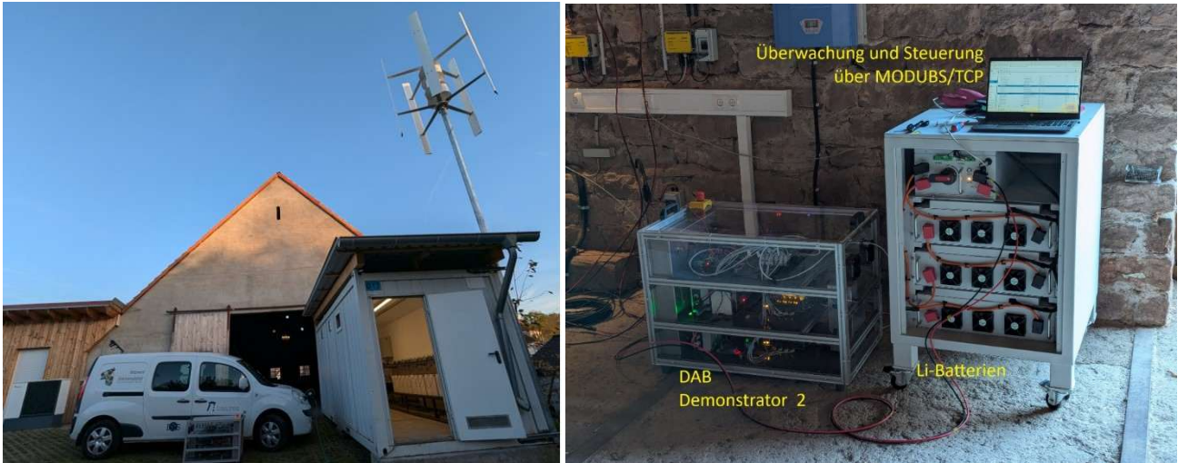
Abbildung 57: Ladegerät nach Transport zum Demo-Gebäude und nach Systemintegration
