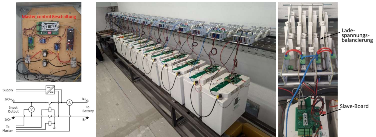
Abbildung 76: Blei-Batteriebank mit BMS. Links: Master-Schaltung, rechts: Slave-Schaltung mit Spannungsbalancierung
