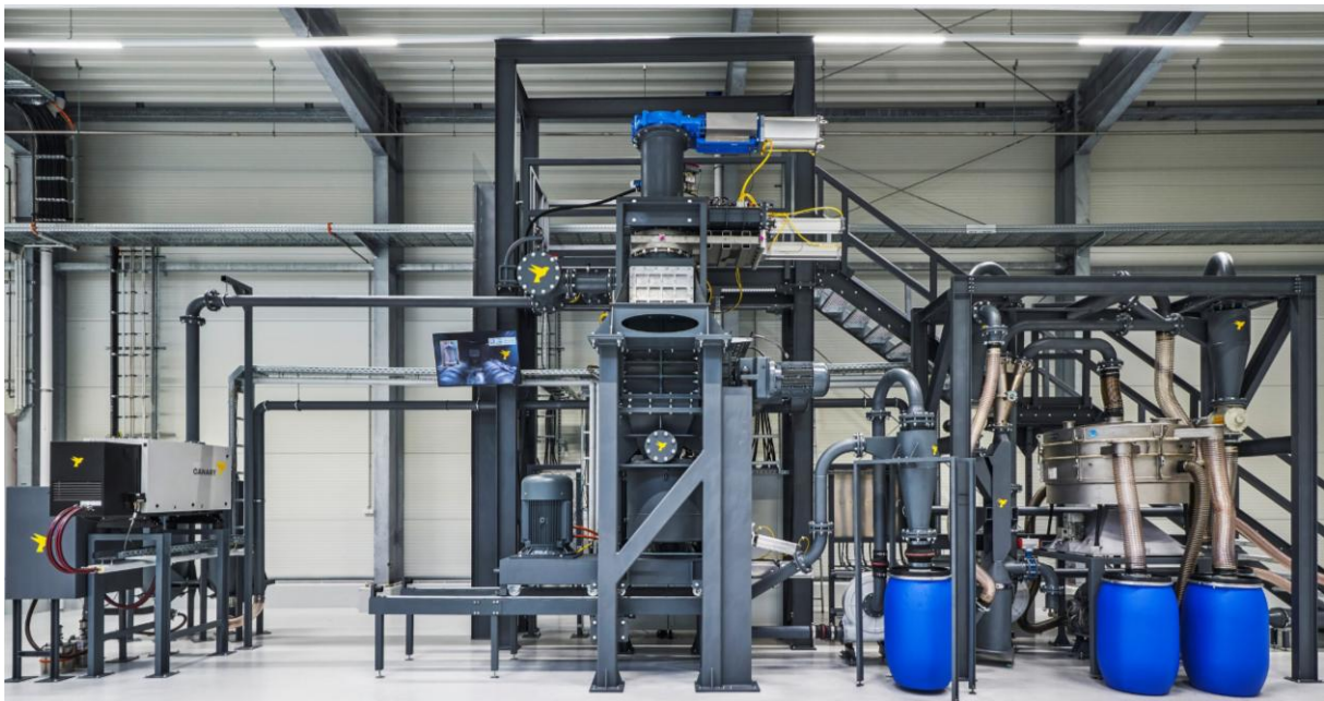
Abbildung 8: Recyclinganlage des iPAT an der TU Braunschweig (November 2023)
