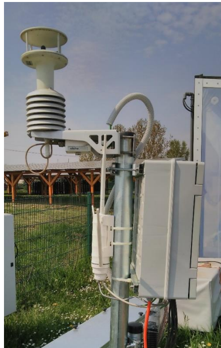
Abbildung 26: Messdatenerfassungssystem mit Schaltschrank, Wetterstation, WLAN-Antenne auf dem Testfeld. Bild: HFT Stuttgart
