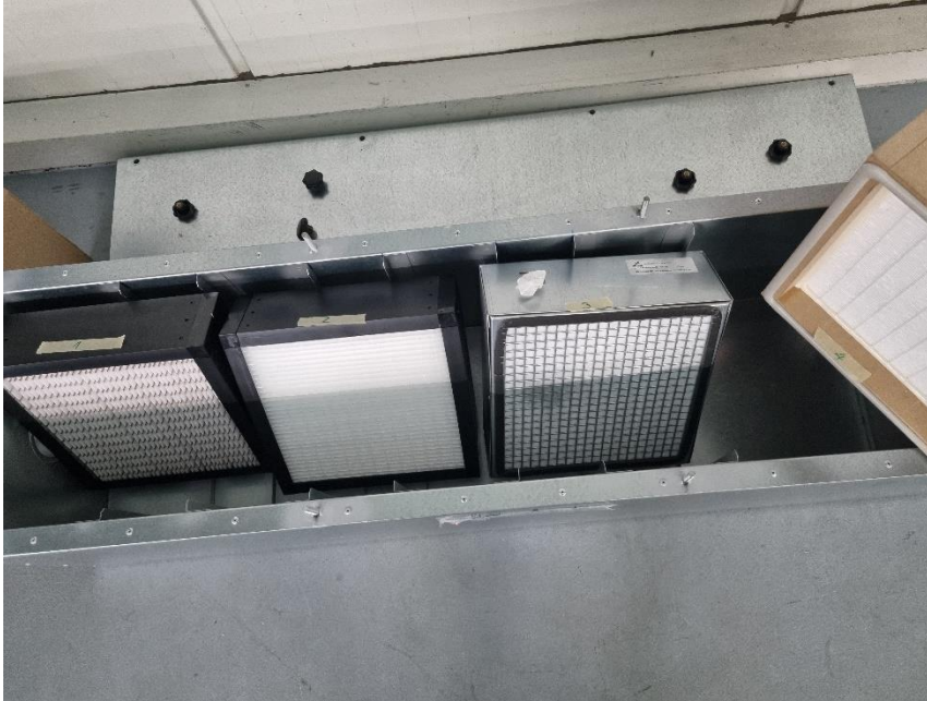
Abbildung 17: Filtersystems der Prozessluft.
