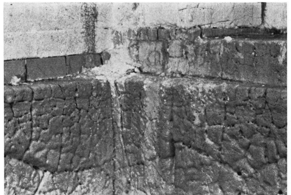
Bild 5. Gerissenes Wannenbecken aus schmelzflüssig gegossenen Korund-Zirkonoxid-Steinen.
