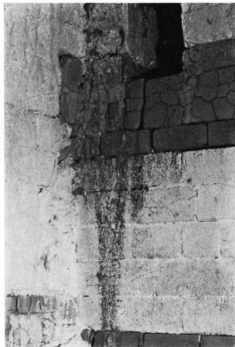
Bild 4. An den Ofenwänden ablaufende Schlacken.
