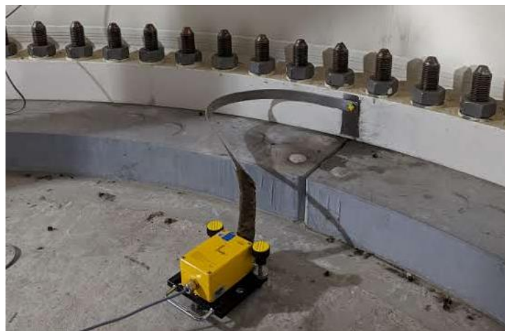
Abbildung 16: Geophon auf dem Turmfundament, neben dem Fußflansch.
