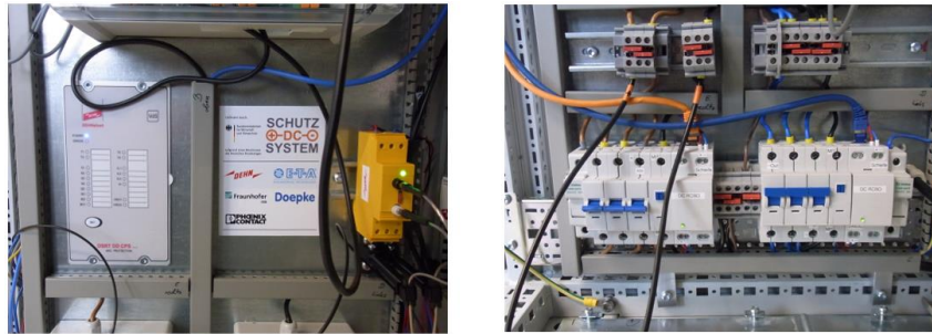
Abb. 2.1.11.-2: Lichtbogendetektionssystem des DC-Kurzschließers von DEHN (links) und DC-RCBO von Doepke (rechts)
