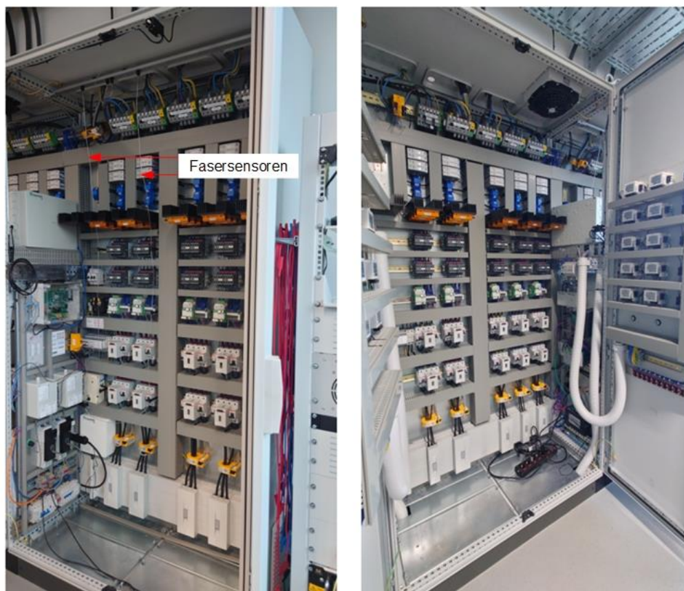
Abb. 2.1.11.-1: Vorder- und Hinterseite des Demonstrators (PRBS Impedanzmesssystem von IISB, Schutzmodul von ETA, DC-Kurzschließer von DEHN, DC-Steckverbinder von Phoenix Contact, DC-RCBO von Doepke und Schutzelement von IISB) in einem Verteilerschrank im DC-Netz des IISB
