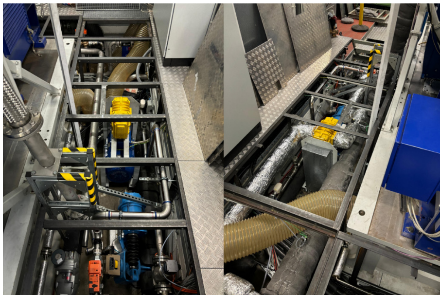
Abbildung 47: AGR-Strecke ohne Verrohrung der Gasleitungen (links) sowie mit Verrohrung und Isolierung (rechts)
