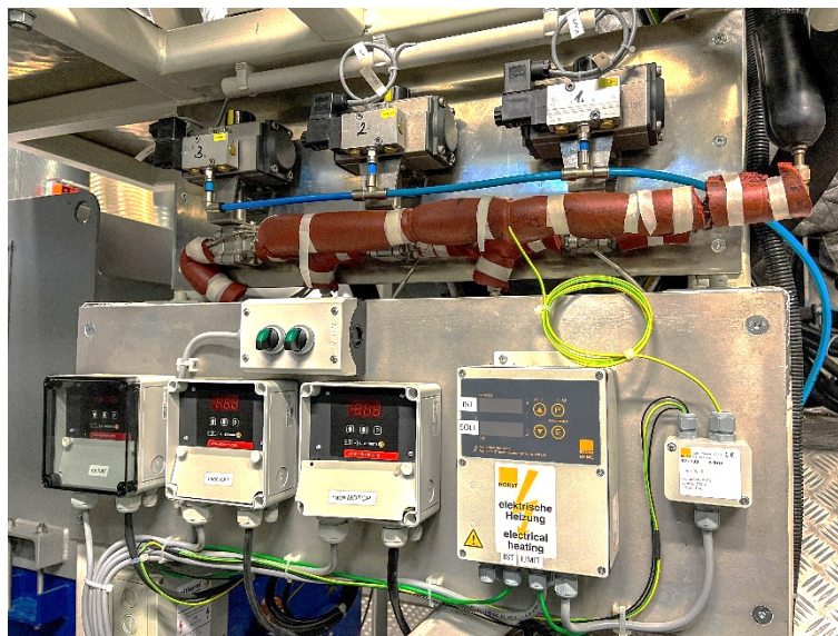
Abbildung 39: Abgas-Wechseinrichtung zur Abgasentnahme an verschiedenen Entnahmestellen
