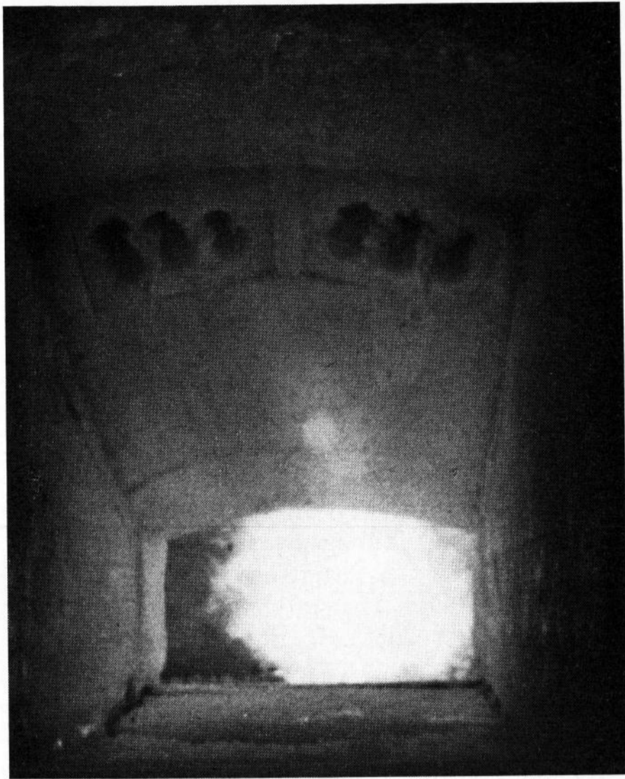
Bild 14. Blick durch den abziehenden Brenner gegen die sich mit Primärluft entwickelnde Flamme.
