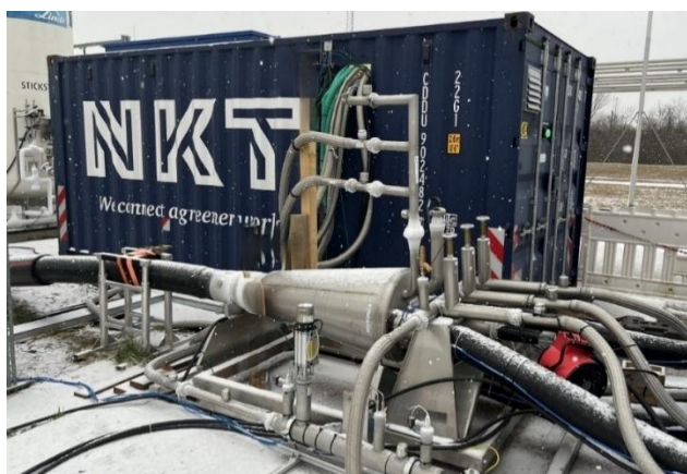
Abb. 6.21: Splitterbox und Kühlcontainer
