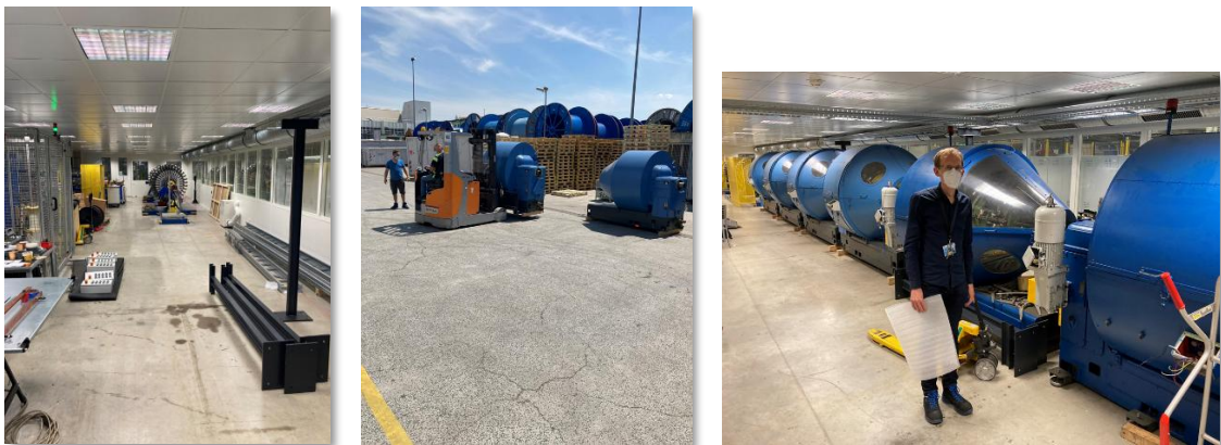
Abb. 6.12: Einbringung der vier zusätzlichen Papierköpfe in die vorhandene HTS-Kabelproduktionsanlage
