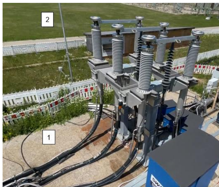
Abb. 6.19: Erdungsseile für Splitterbox und Endverschlüsse (1) sowie Blitzableiter (2)
