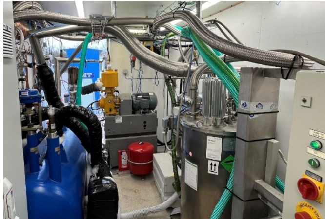
Abb. 6.22: Komponenten innerhalb des Kühlcontainers
