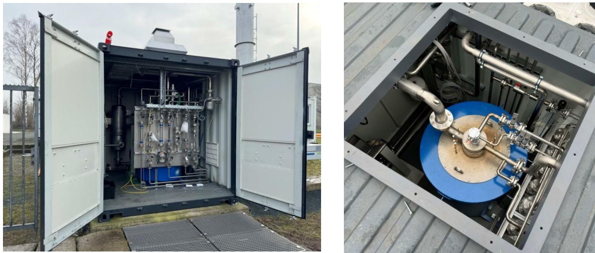
Abb. 8: ADROX Reaktor im Container der Anlage. Links: Medienanschlüsse oben. Rechts: Medienverteilung und Volumenstromkontrolle auf Schalttafel.
