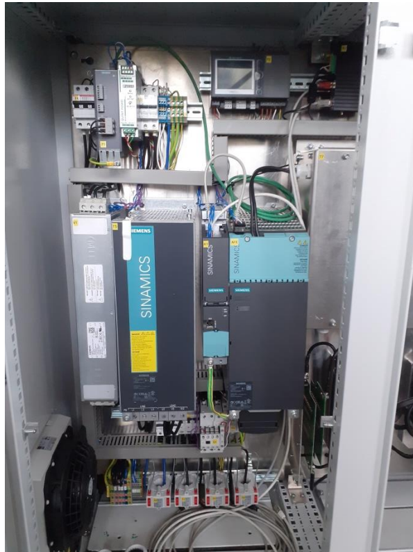
Abbildung 2-13: AFE im Schaltschrank, Zukaufteil, Siemens
