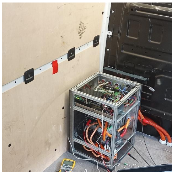
Abbildung 2-33: Sekundärseitige Leistungselektronik während des Einbaus in das Fahrzeug
