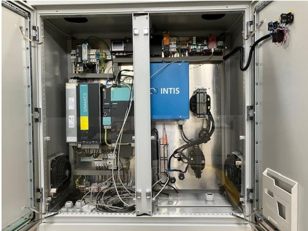
Abbildung 2-23: Anordnung der Primäreinheit im Schaltschrank
