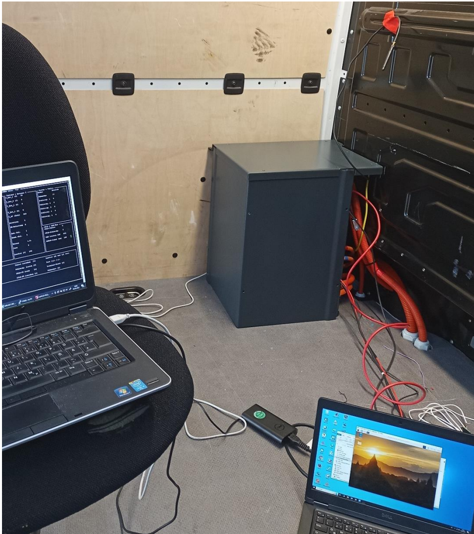
Abbildung 2-57: Inbetriebnahme des Ladesystems im Fahrzeug
