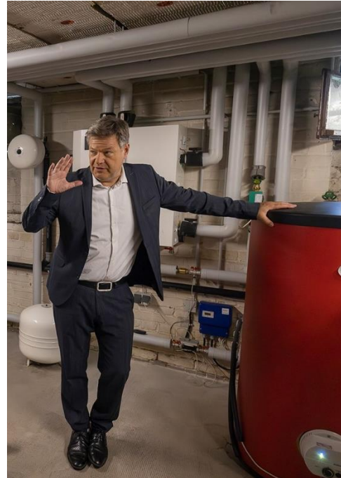
Abbildung 7 Besuch des Bundeswirtschaftsministers Robert Habeck in einer Pilotinstallation (Heizstab mit decarbon1zer) der Vonovia, Juli 2024 Bild: decarbon1ze
