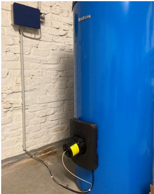
Abbildung 2 Vorbereitung der Feldtestinstallation einer Power to Heat Anlage im Gebäudebestand in Berlin mit A-Musterstand des DICAMM. Bild: decarbon1ze
