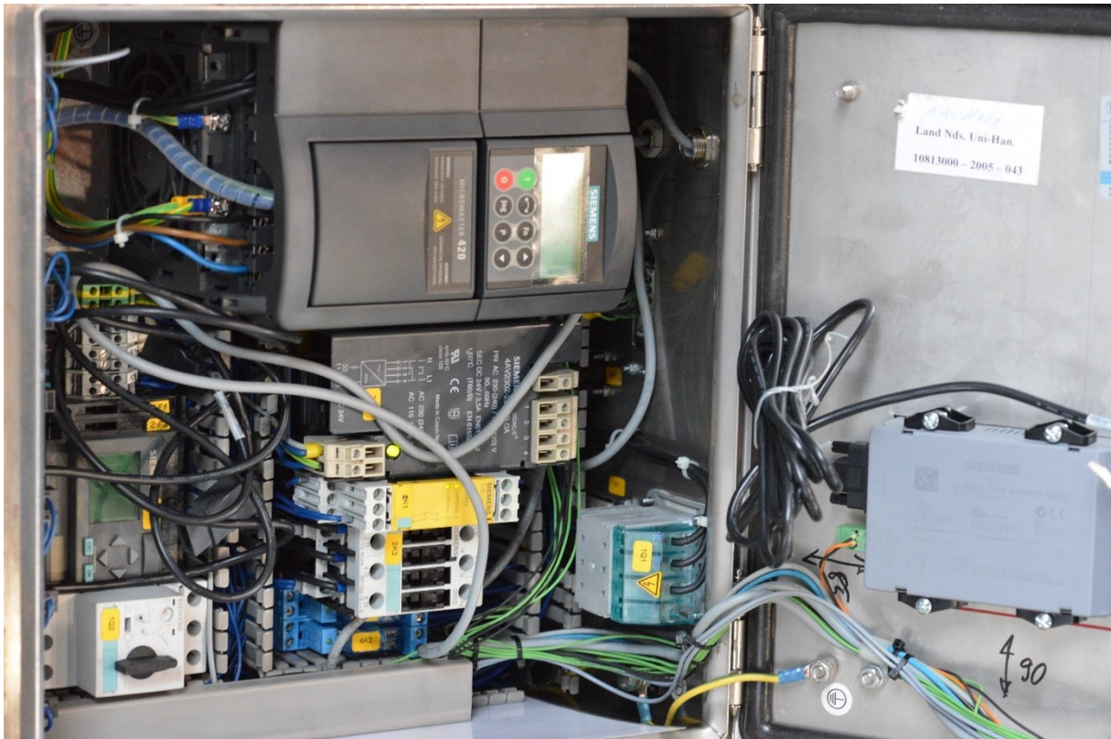
Abbildung 21: Im Schaltkasten der WASS Anlage verbauter Frequenzumrichter vom Typ Siemens Micromaster 420
