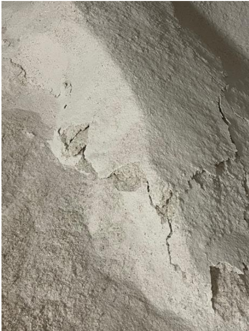
Abbildung 46: Oberflächliche Salzschorlenbildung auf KOMPASS-Material (Foto Autor)
