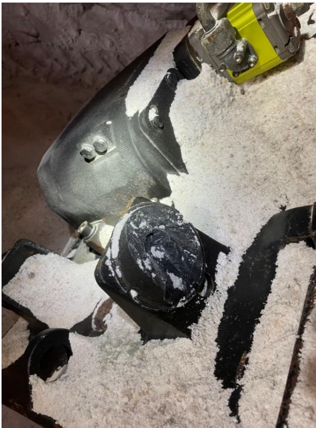
Abbildung 47: Gerissene Gummilagerung bei Vibrationsanbauplatte (Foto Autor)
