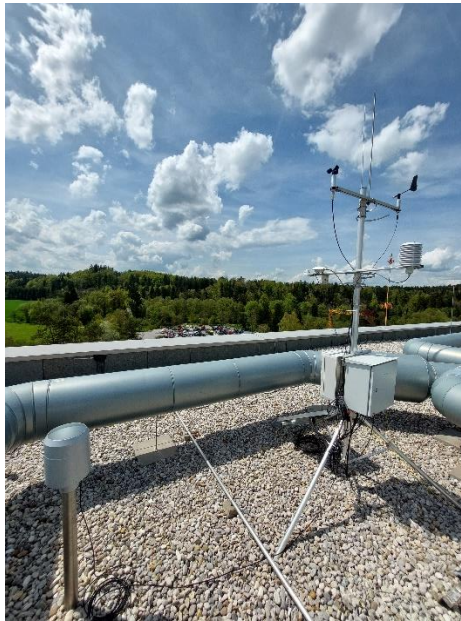
Abbildung 40 Aufgebaute Wetterstation auf dem Dach von puls G
