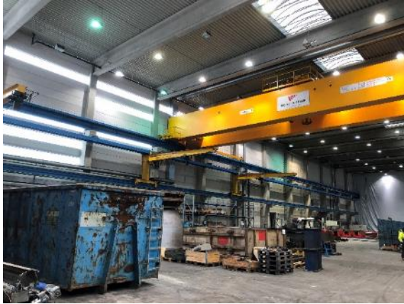
Abbildung 38: Hallenkräne mit 16 bzw. 105 Tonnen Traglast [ZSW]
