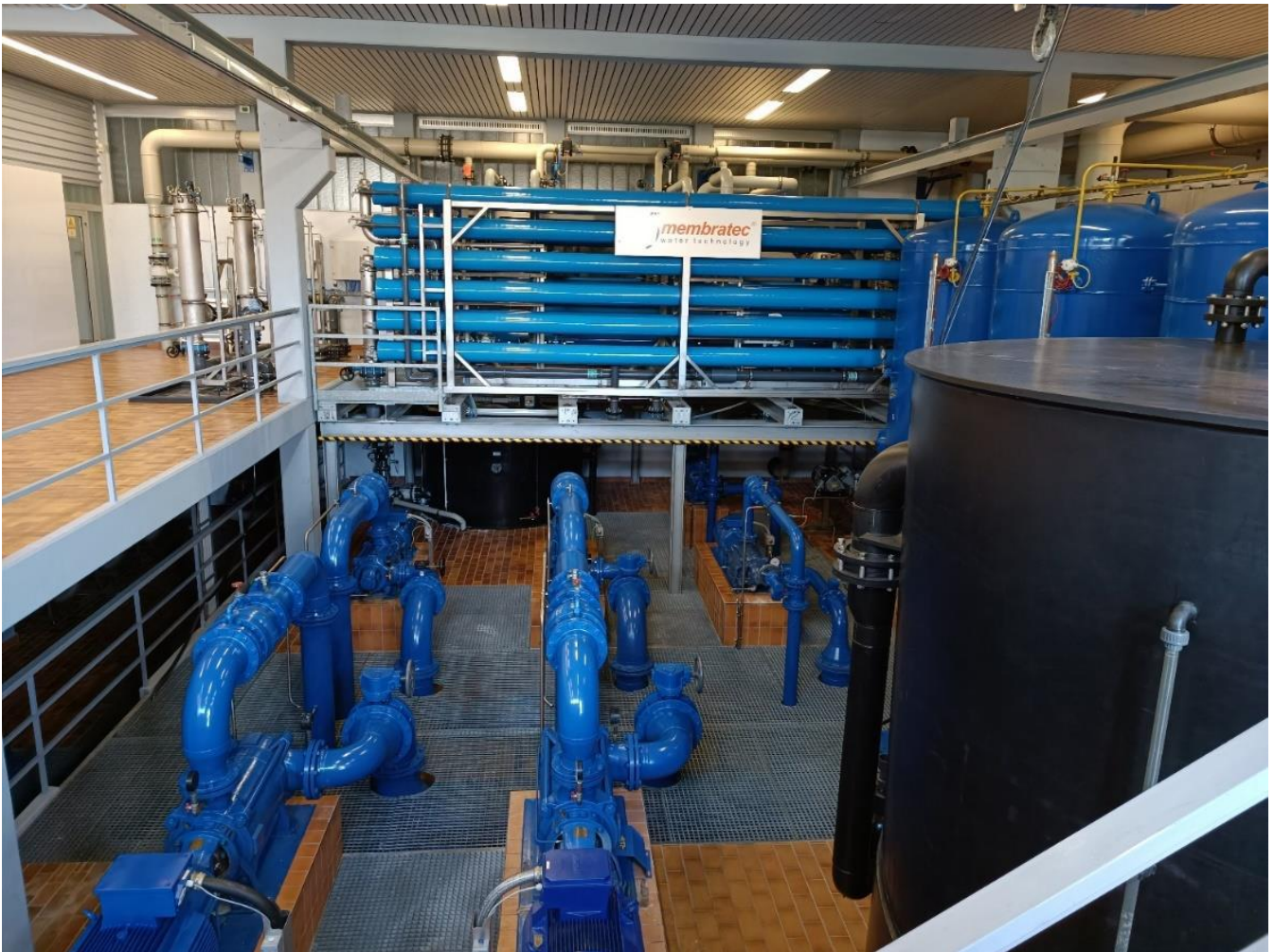
Abbildung 2: Zentrale Pumpstation mit Druckwindkesseln und Enthärtung
