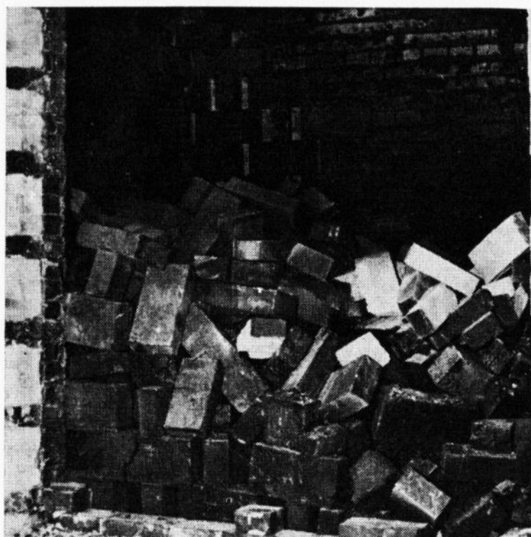
Bild 1. Eingestürztes Gitterwerk im Bereich der 18. bis 28. Steinlage (von oben gerechnet).
