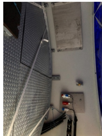
Abbildung 80: Ebenfalls abgenommen wurden die Podeste und Einbauten, wie z. B. vormontierte Bleche zur Anbringung der Messtechnikschränke, Anschlagpunkte zur Sicherung oder Kranluken. [ZSW]
