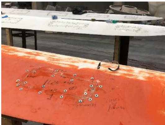
Abbildung 83: Die Öffnungen wurden nach der Installation der Sensoren wieder verschlossen. [ZSW]
