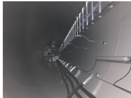
Abbildung 78: Blick in das Innere eines Stahlrohturms mit den vorinstallierten Leitersegmenten, Kabeltrassen und Leistungskabel. [ZSW]
