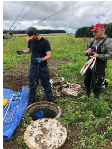
Abbildung 21: Einbringen des seismischen Messgeräts durch Wissenschaftler des Geophysikalischen Instituts GPI des KIT in den vorbereiteten Schacht. [ZSW]
