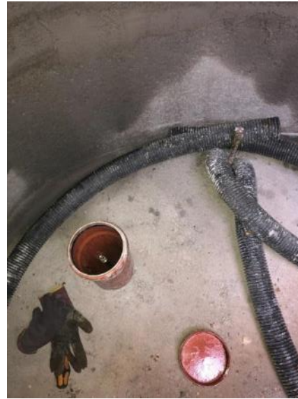
Abbildung 32: Nach dem Setzen der Zugangsschächte sind das schwarze Schutzrohr sowie das orange Hüllrohr zugänglich. Zu erkennen im Hüllrohr ist der obere Teil der Extensometerstange [ZSW]
