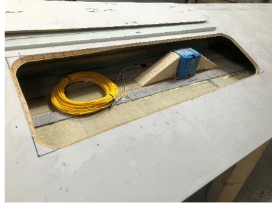
Abbildung 82: Im Bereich der Rotorblattspitze wurden die faseroptischen Beschleunigungssensoren appliziert und mit dem Rotorblatt verklebt. [ZSW]
