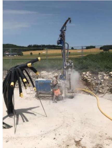
Abbildung 25: Bohrung der sechs unterschiedliche tiefen Löcher durch Beton und Fels für die Applikation der Extensometerstangen (vgl. 1. Punkt der Ausführungsplanung) [ZSW]
