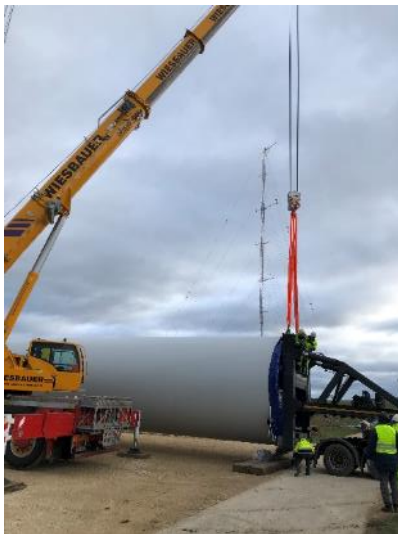
Abbildung 102: Nachdem die richtigen Anschlagmittel beschafft wurden, konnten die LKWs entladen werden. [ZSW]
