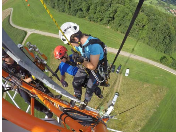
Abbildung 3: Übung unter realen Bedingungen - Bergung einer am Windmessmast verunfallten Person mittels Rettungshubgerät. [ZSW]
