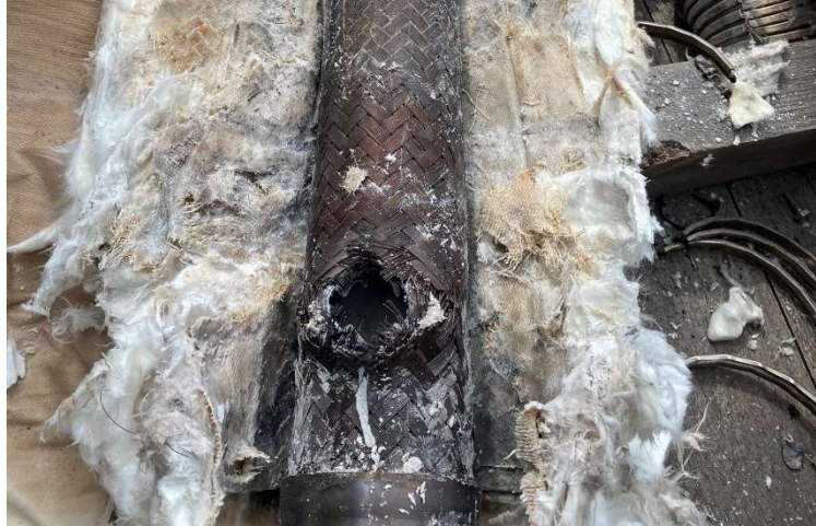
Abbildung 28 Geborstener Flexschlauch vom REPA auf der EMSP
