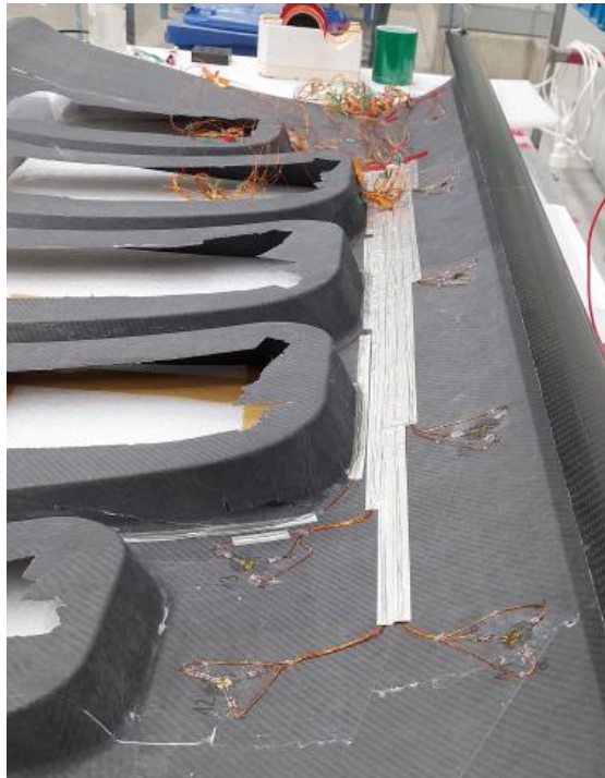
Abbildung 3.21: Segment mit applizierten DMS Sensoren und geschirmten Kabeln. Hinweis: Die Schirmung der Kabel ist in diesem Status noch nicht vollständig ausgeführt.
