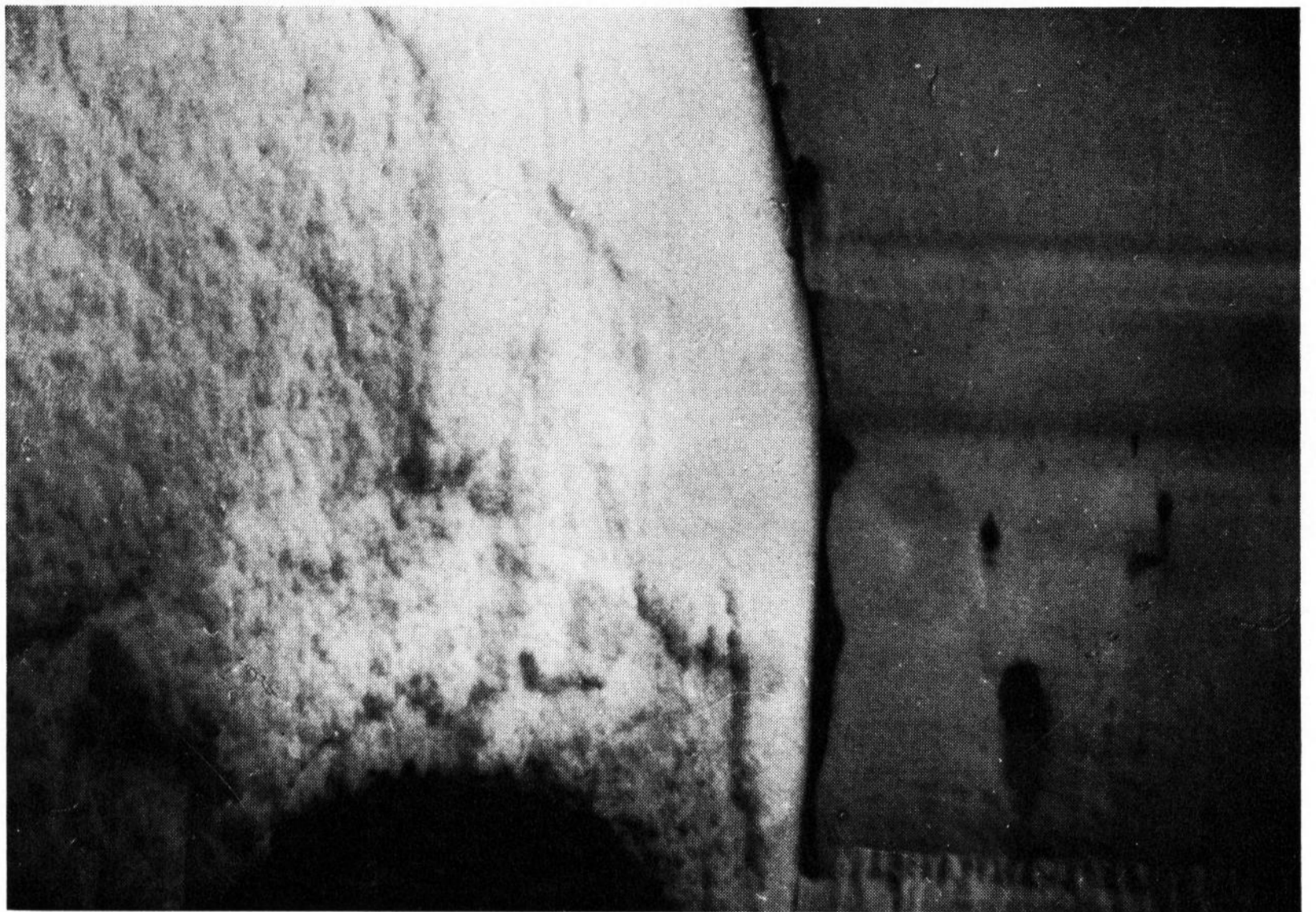
Bild 5. Stirnwand einer Querbrennerwanne, Anschluß an die Seitenwand ( 1/125 s).
