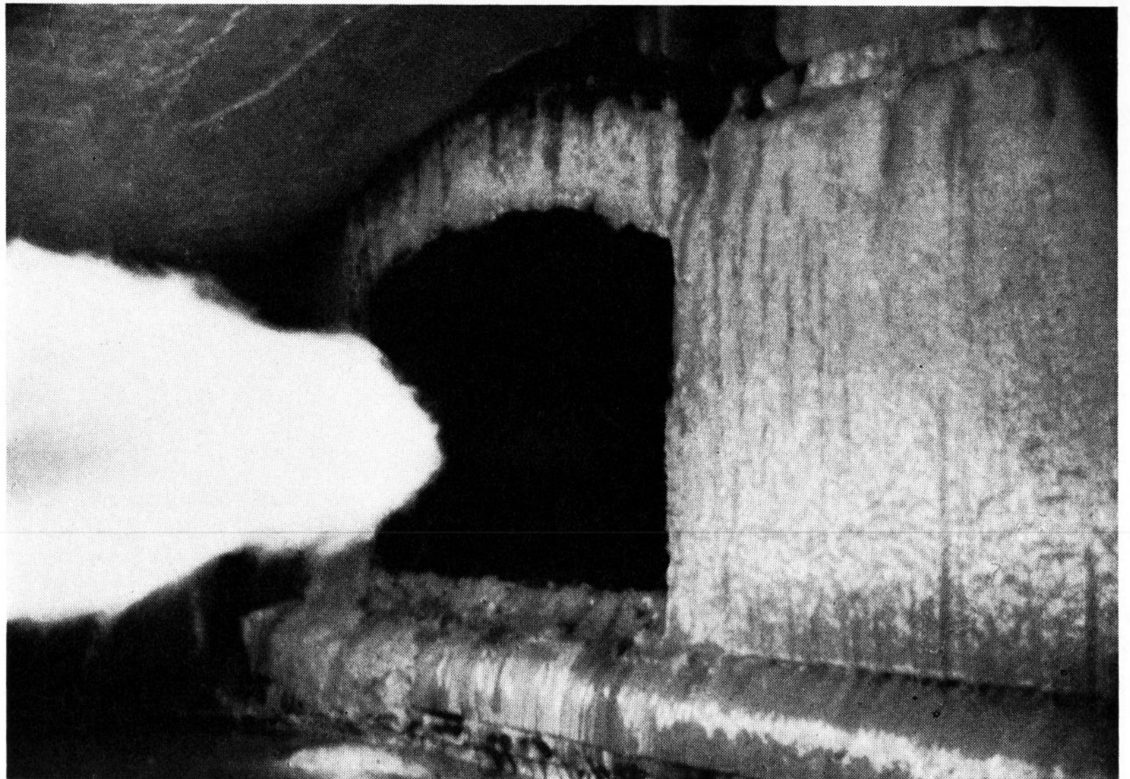
Bild 4. Stirnwand einer U-Flammenwanne, Brennermaul und Flamme ( 1/30 s).
