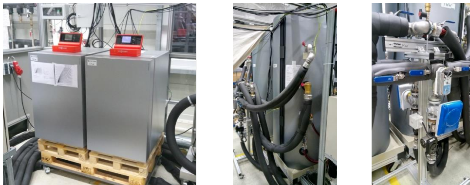
Abbildung 1-23: Wärmepumpenkaskade (links); Speicher zur Raumheizung und Trinkwassererwärmung mit je 1000 l Volumen (Mitte); zwei 3-Wege Ventile zur Speicherbelastung (rechts)
