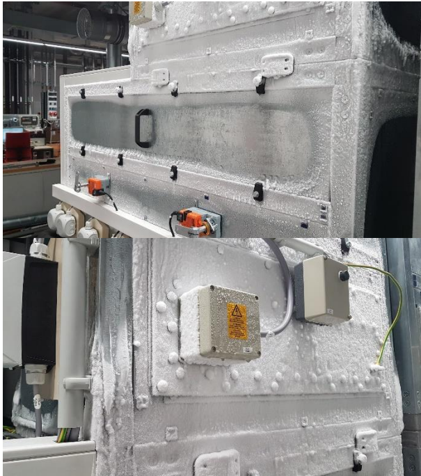
Abbildung 2-31 - Kondensation und resultierende Reifbildung an Luftleitungen.
