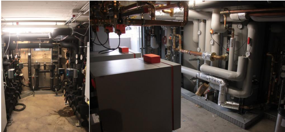
Abbildung 1-39: links: Heizungskeller 1 mit Wärmequellenhydraulik und Gaskessel; rechts: Heizungskeller 2 mit Wärmepumpen und Speicher
