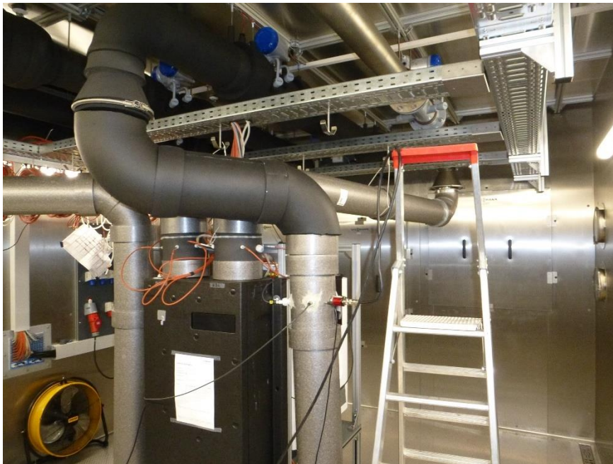
Abbildung 2-28 - Linker Innenraum des Prüfstandes, augenblicklich mit einem Prüfling einer zentralen Lüftung inklusive der entsprechenden Sensorik. Die beiden schwarzen Griffe im Hintergrund markieren die Position einer der beiden Klappen, die entfernt werden können zur Prüfung von dezentralen Lüftungsgeräten.
