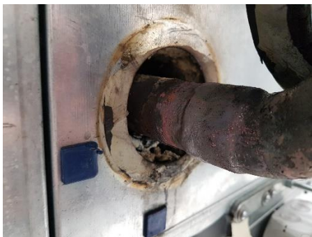
Abbildung 2-30 - Nicht fachgerecht ausgeführte Lötarbeiten.
