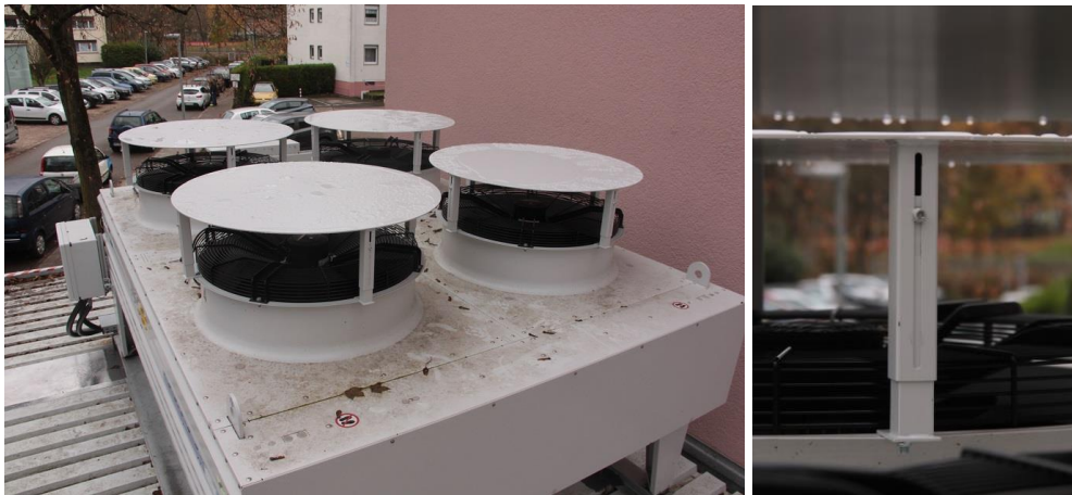
Abbildung 1-12 Tischrückkühler mit installierten, höhenverstellbaren Regenschutzüberdachungen.
