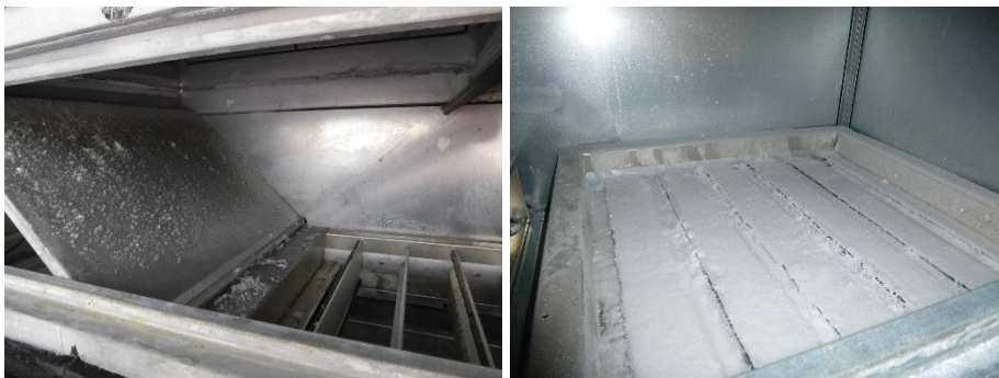
Abbildung 2-32 - Kondensation und resultierende Reifbildung an Umschaltklappen.
