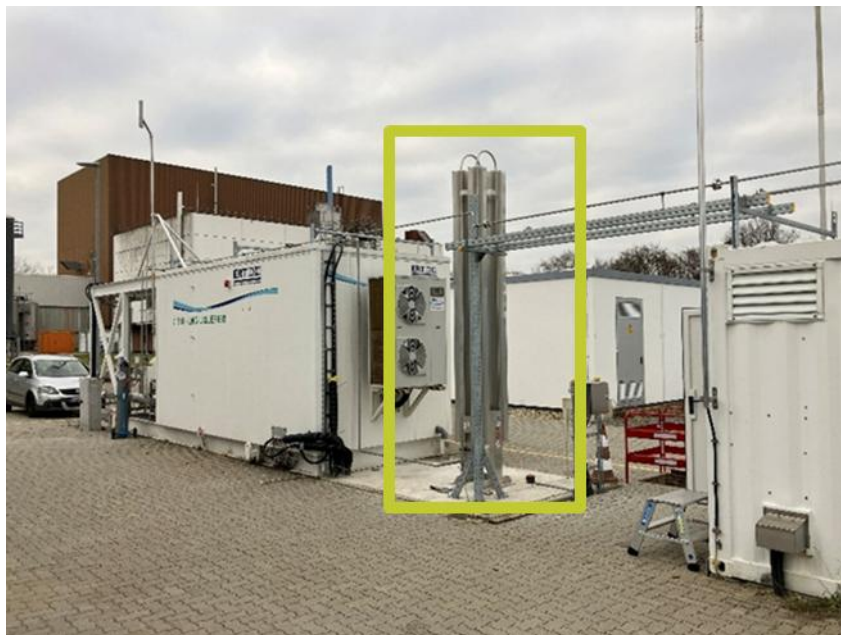
Abbildung 19: Aufbau des Wärmeübertragers und der Rohrleitungen zwischen Methanisierungsanlage (rechts) und Verflüssiger (links).
