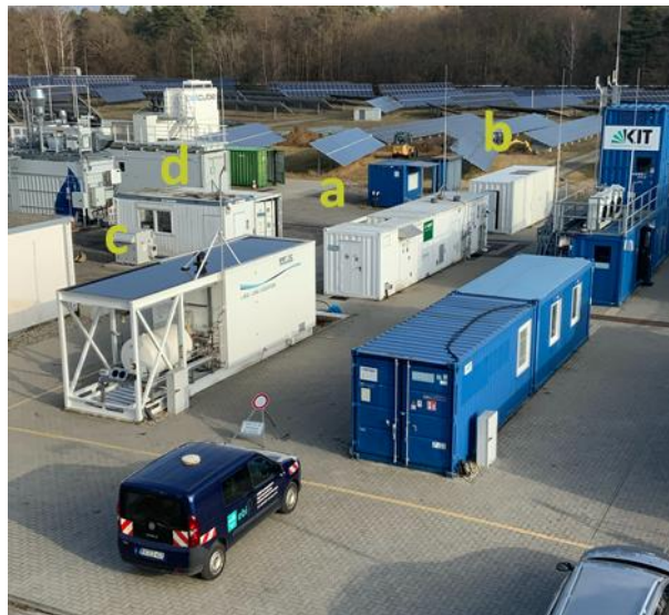
Abbildung 17: Methanisierungs-Anlagenverbund am KIT Energy Lab, a: Methanisierung; b: Gasaufbereitung; c: Verflüssigung; d: Leitwarte.
