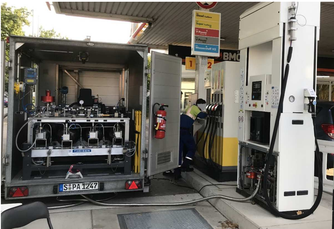
Abbildung 1: H 2 -Zapfsäule, zwischen herkömmlichen Zapfsäulen angeordnet, mit Abnahmegarät FSTM
