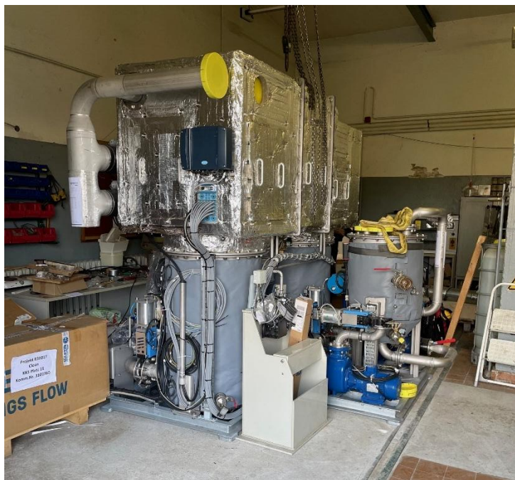
Abbildung 2-18 Anlage in Hohen Luckow
