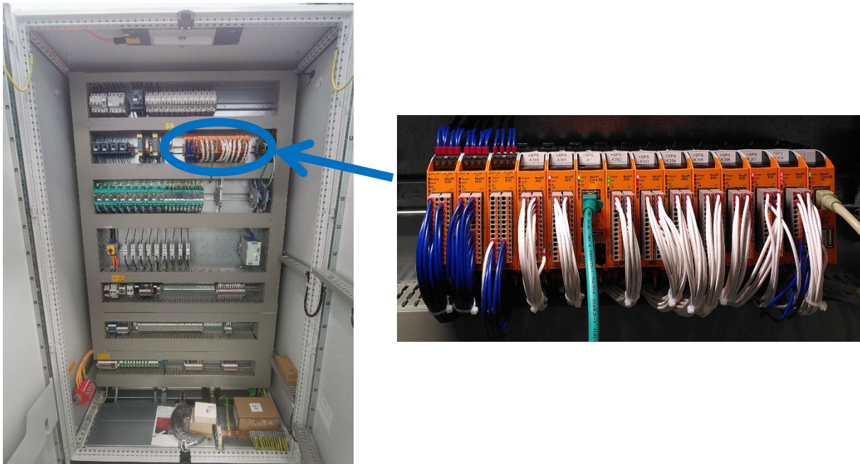
Abbildung 72. Steuerschrank (links), Master- u. Slave-CPU mit I/O-Baugruppen (rechts).
