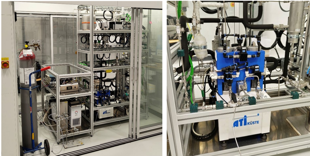
Abbildung 46. Gesamt- und Detailansicht des PSA-Demonstrators in der MEGA-Gesamtanlage.
