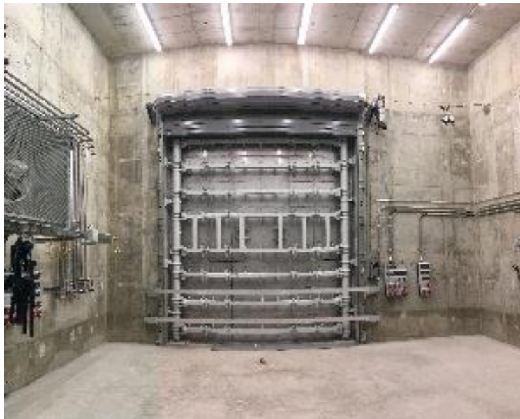
III- 2: Versuchsebene 1 Nord-Panorama mit Öffnungsstrahlungsschutz
