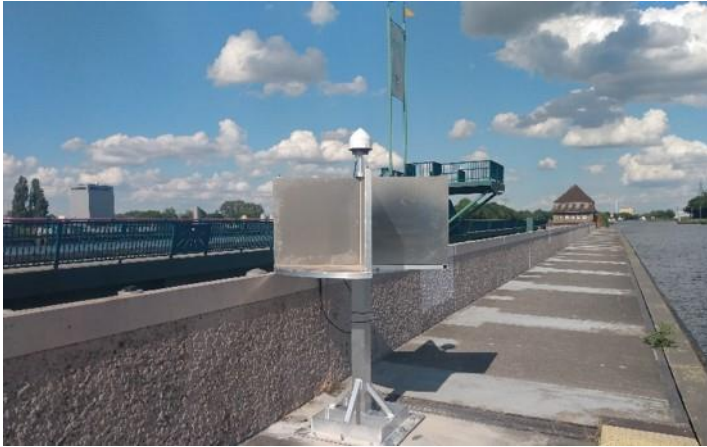
Abbildung 6: Multisensor-Station DCR600 auf der Brücke (DCRB). [ALLSAT GmbH, 2023]
