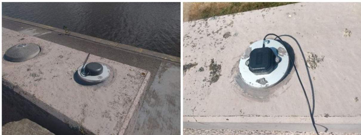
Abbildung 7: Lowcost GNSS-Antennen auf der Brücke. [Geo++ GmbH, 2023]
