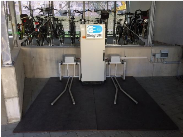
Abbildung 2.3.9: Zwei Ladestationen am Standort SWG
