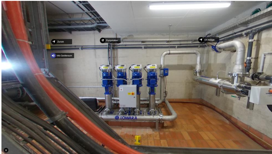
Abb. 15. Screenshot H5P 360° View Tour für eine UV-Anlage zur Hygienisierung von gereinigtem Abwasser
