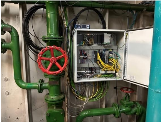
Abbildung 24 Schaltschrank der Navigationsplattform im Maschinenraum
