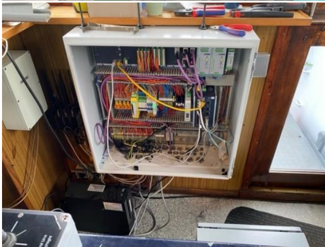
Abbildung 25 Schaltschrank der Navigationsplattform im Steuerhaus
