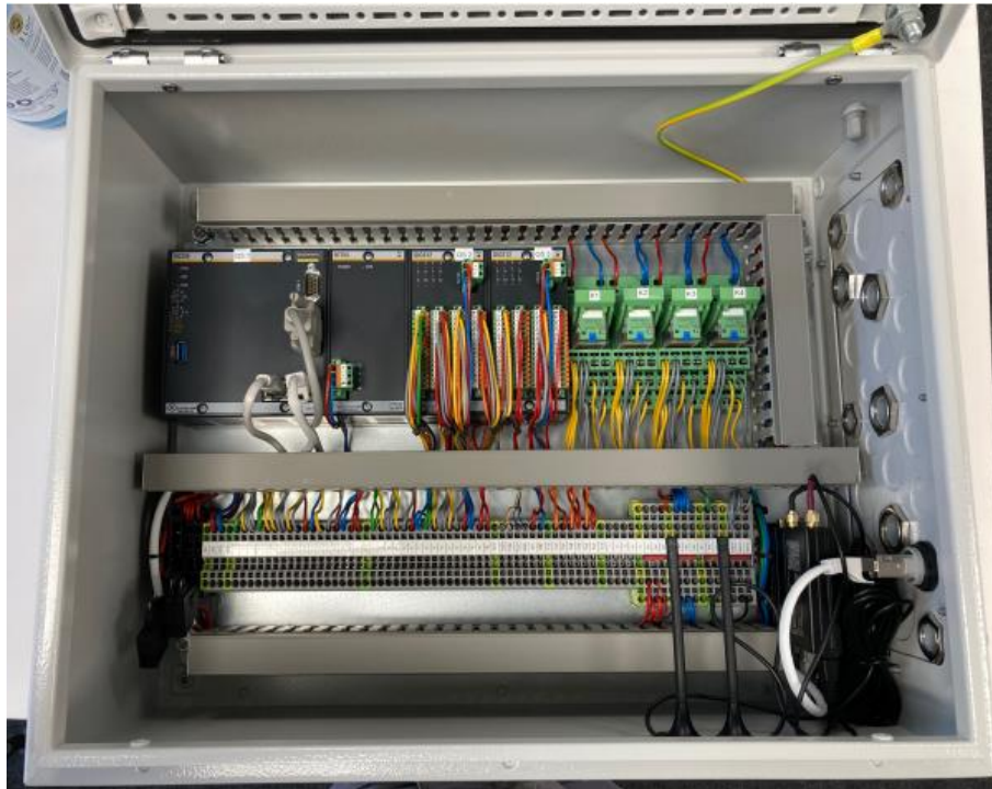
Abbildung 52 SPS-Schaltschrank zur Ansteuerung der physischen Bedienelemente SPS-Schaltschrank zur Ansteuerung der physischen Bedienelemente
