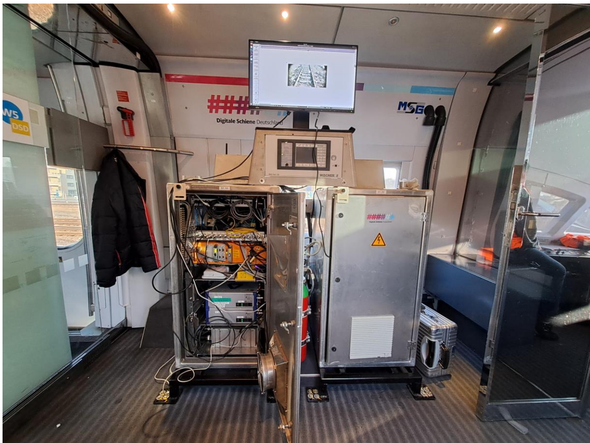
Abbildung 6.6: Messwertaufzeichner und Messtechnik im Serverschrank des aTL. Der Monitor wurde während den Testfahrten zur Visualisierung der Signale verwendet.
