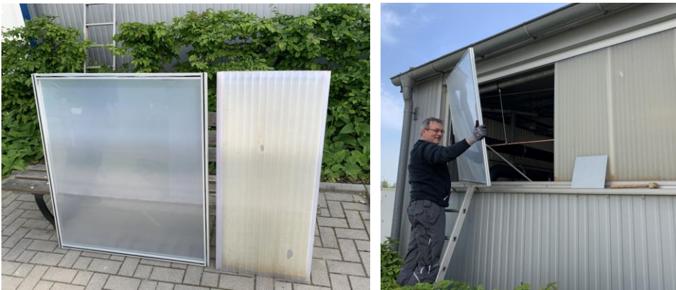
Bild 18: Light-Light-Roof-Modul und defekte Polycarbonat-Doppelstegplatte (links) und Montage der Light-Light-Roof-Module im Lichtausschnitt der Leichtbauhalle am Standort des Fraunhofer UMSICHT in Oberhausen (rechts).
