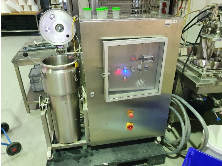
Abbildung 21: Links: „Vermahlungskammer“ des Hydrogrind; Rechts: Steuereinheit des Hydrogrind
