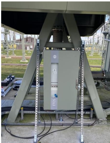
ETOS System im UW Wister West
