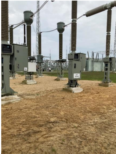
UW Wilster West: Sensorische Anbindung der Leistungsschalter
