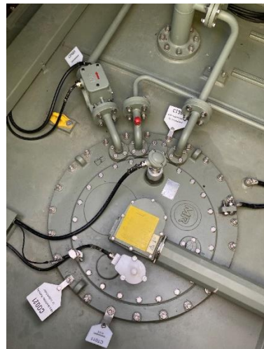
Sensoren am Stufenschalter im UW Wilster West
