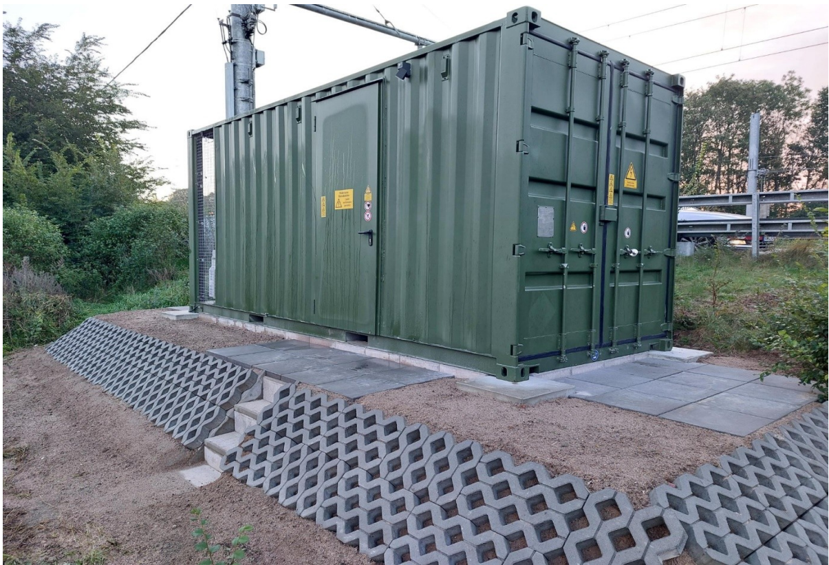
Abbildung 10 Speicherunterwerk am Aufstellungsort
