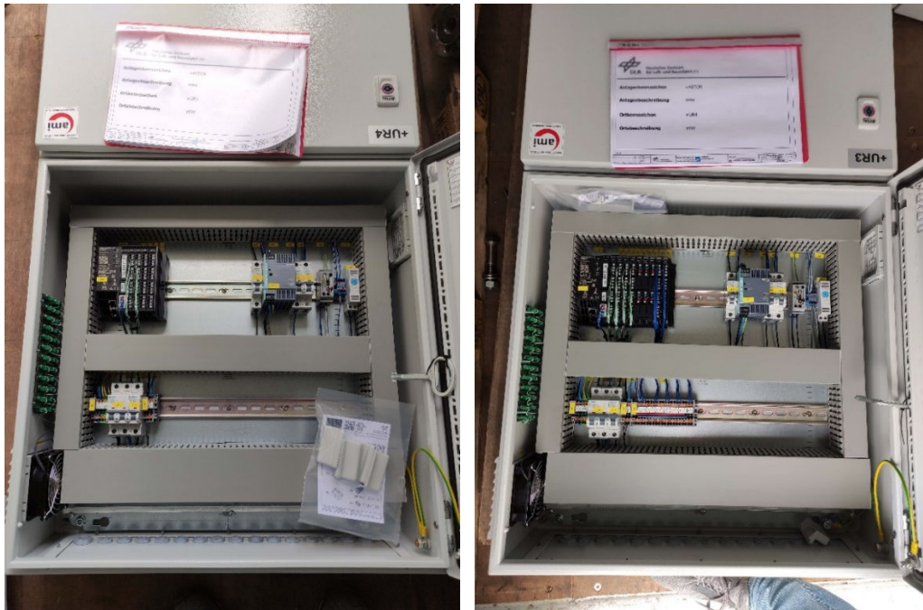
Abbildung 74: Schaltschrank UR3 Attrappe1+2 links und UR4 Attrappe3+4 rechts mit Weidmüller EA-Baugruppen UR5 regelt das Kühlsystem für den Sekundärkonzentrator, wie in Abbildung 75 zu sehen.
