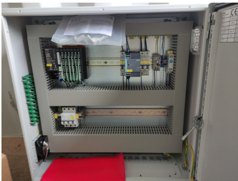
Abbildung 75: Schaltschrank UR5 Seko mit Weidmüller EA-Baugruppen Im Prozessleitsystem Labview wurde hierfür von S&V folgendes Bild gezeichnet.
