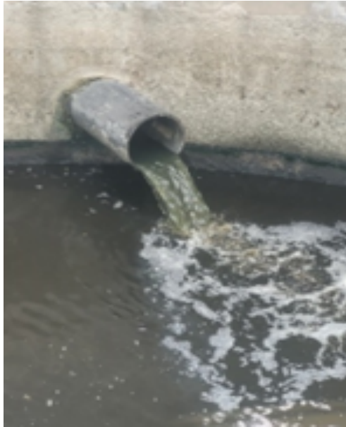
Abbildung 5: Homogenisationstank der Kunnankalpalayam Common Effluent Treatment Plant (CETP) in Tirupur, Tamil Nadu, Indien in welchem das textile Abwasser der einleitenden Textilfabriken gesammelt und vermengt wird.
