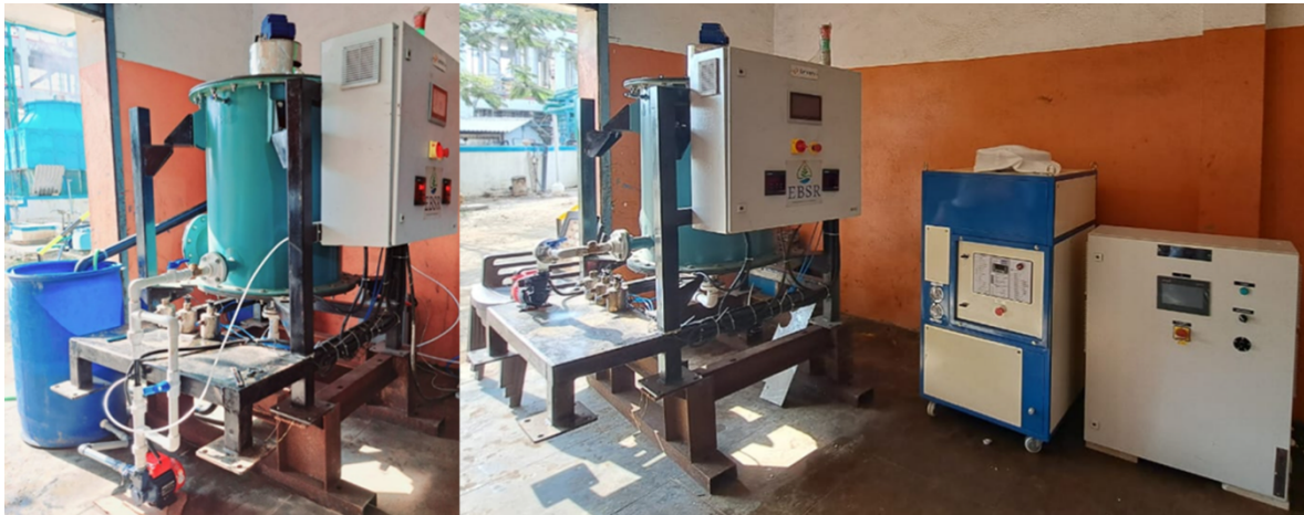
Abbildung 3: Pilotreaktor installiert an der Kläranlage in Kunnakalpalayam CETP, Tiruppur
