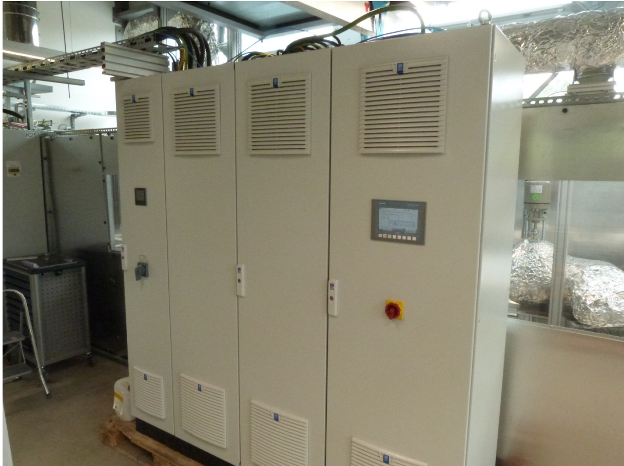
Abbildung 3: Schaltschrank mit der Steuerung für den Durchlauferhitzer der Firma Schniewindt (Foto)
