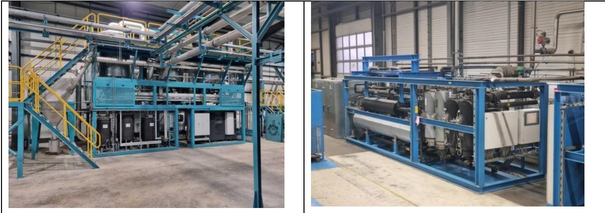
Abbildung 18: Prozessgasbehandlungsanlagen - Adsorptionsanlage (links), Kryogeanlage (rechts)...
