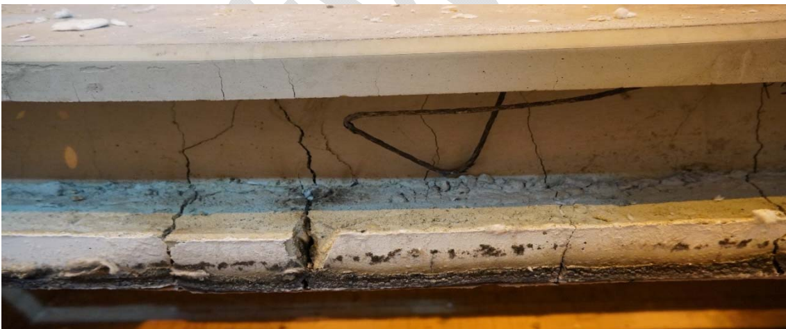
Abbildung 23: Detailansicht in Feldmitte nach der Brandprüfung (Blick aus Richtung Nord)
