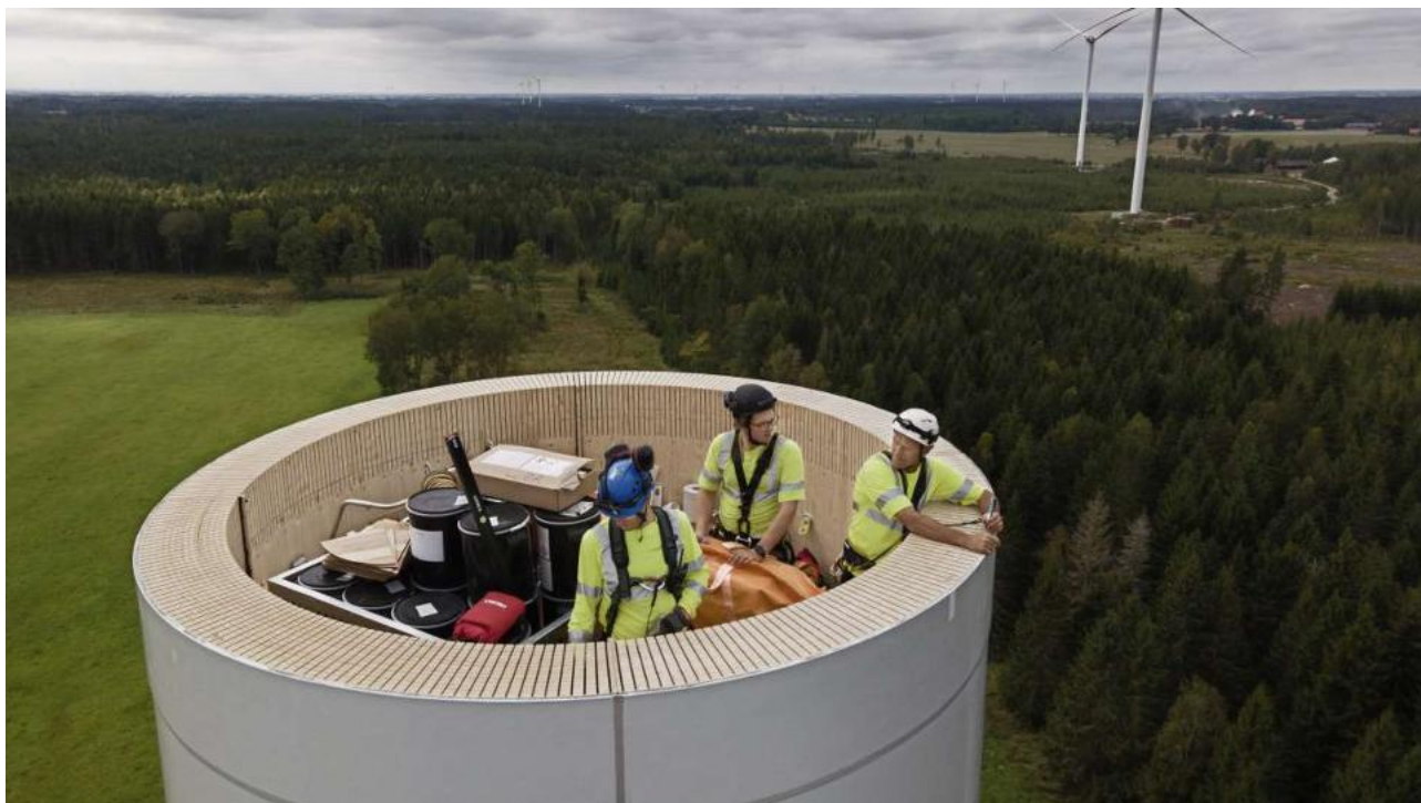
Abbildung. 43: Turm für eine Windkraftanlage in Schweden aus Furnierschichtholz im Bau (Bild: Modvion)
