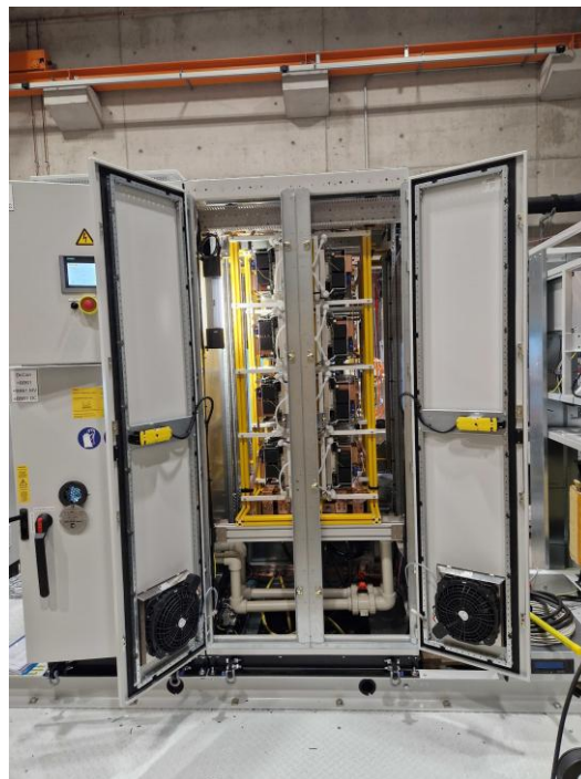
Abbildung 1-39: Foto des MV-DC-DC Wandlers.
