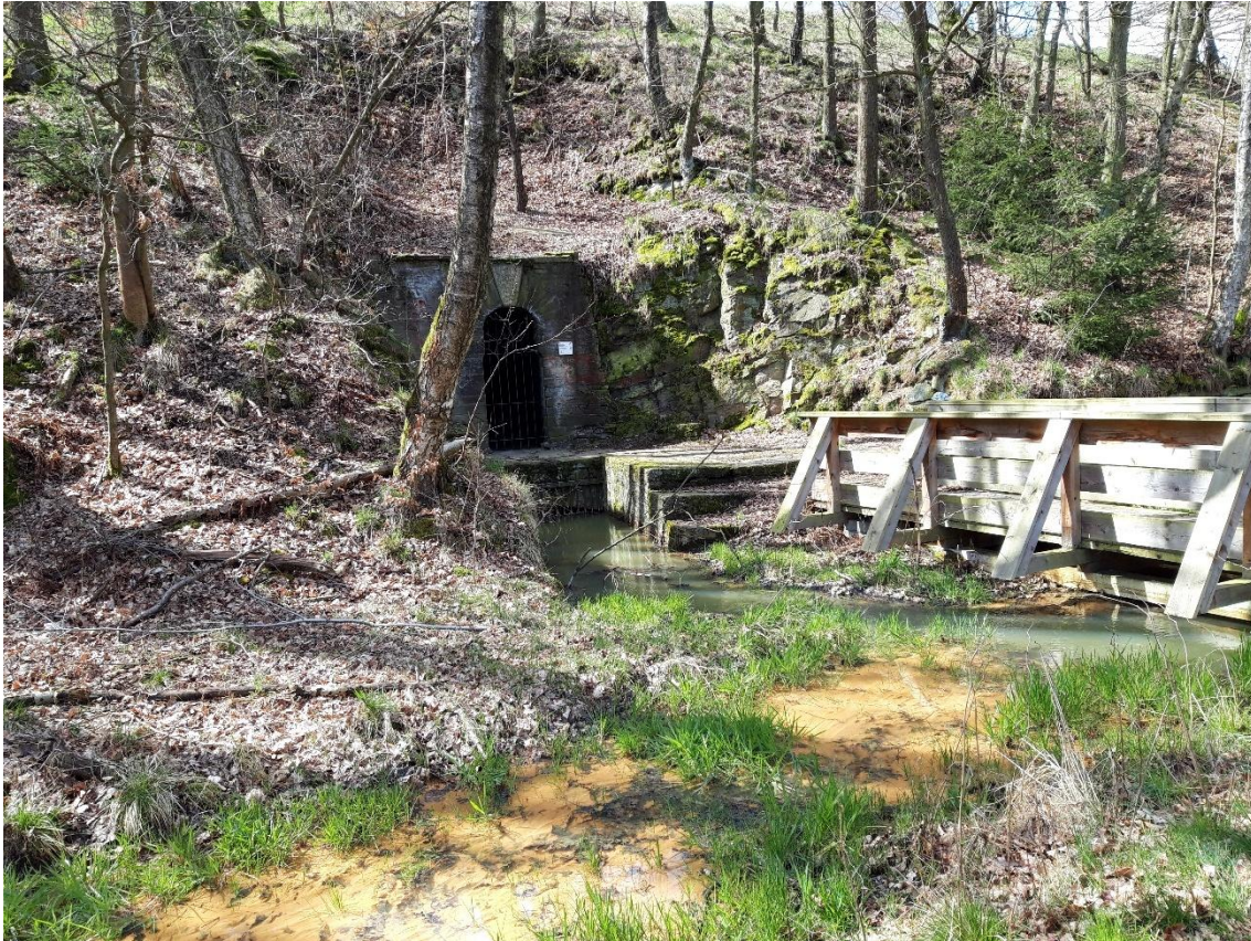
Abbildung 2: Der mit Schlamm zugesetzte Rote Graben am Mundloch HSU.
