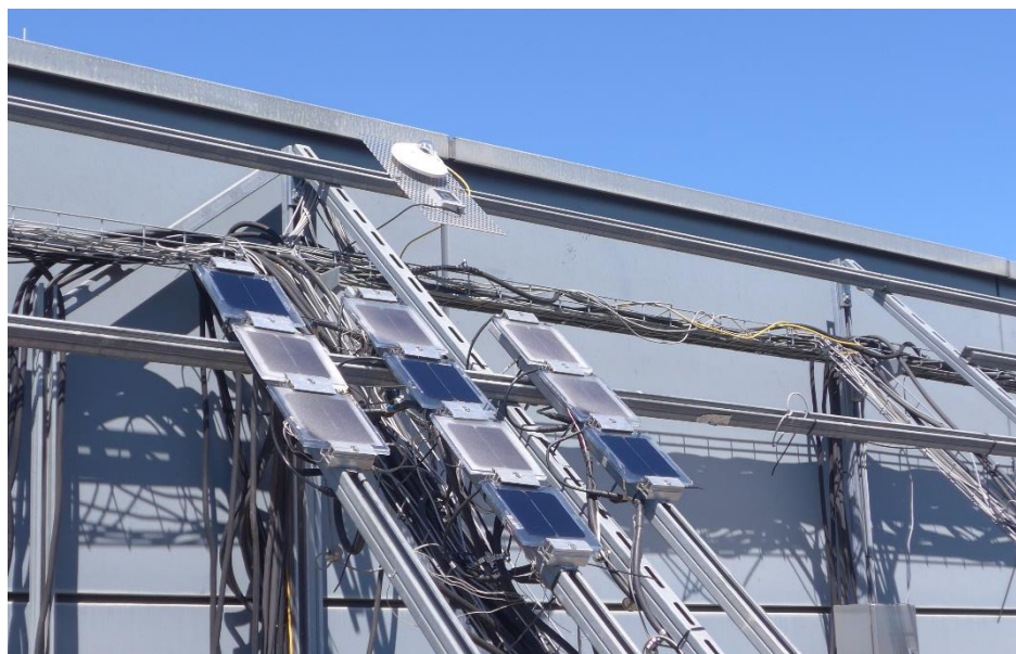
Abbildung 72 Minimodule in Aufständerrung auf dem Dach des Fraunhofer ISE.
