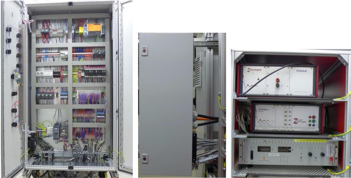
Abbildung 6: Schaltschränke und Leistungselektronik des Teststandes für das erweiterte Betriebsfenster.
