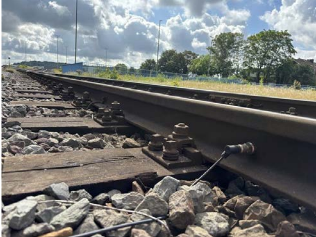
Abbildung 21: Körperschallsensor von außen am Gleis mit Magnethaftung; Anbindung an die Schall-Sensorik-Box über Kabel
