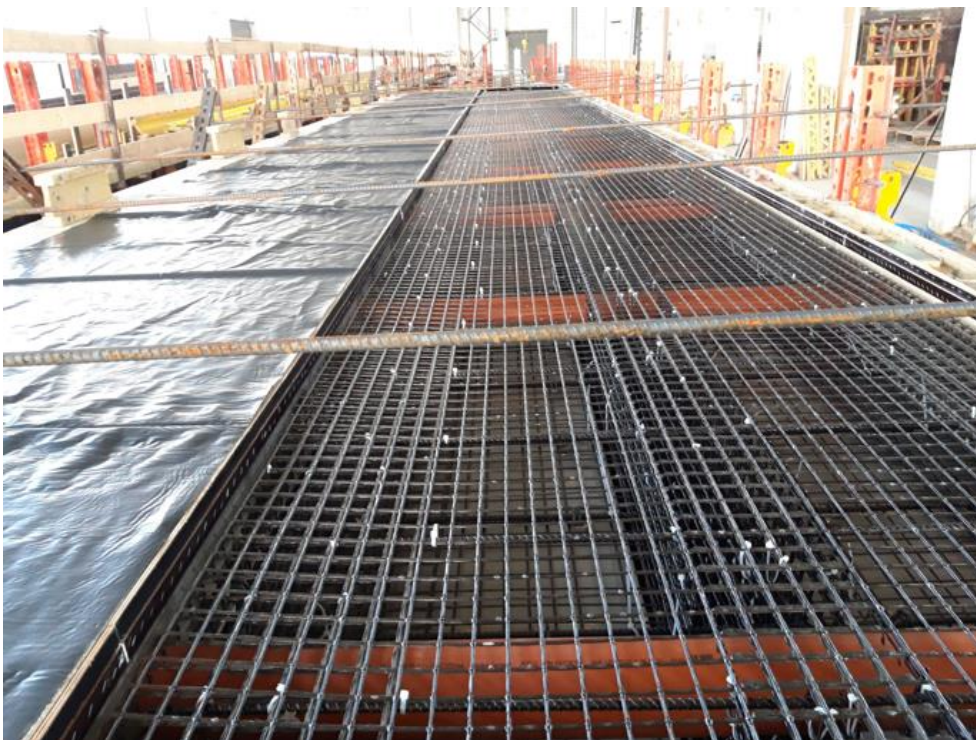
Bild 9: Blick in die Schalung unmittelbar vor Betoneinbau, seitliche Abschalung der Kontaktfläche durch vorher hergestelltes und geschütztes (Folienabdeckung) FT links im Bild
